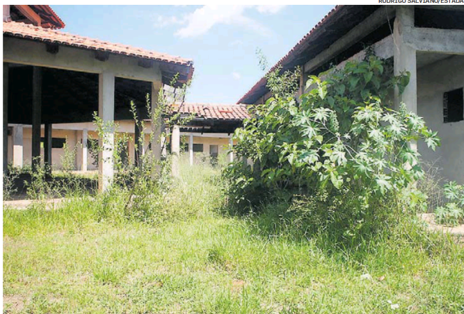
Em Inhumas, Goiás, mato tomou conta da área onde começou a ser construída uma escola; obra parou
